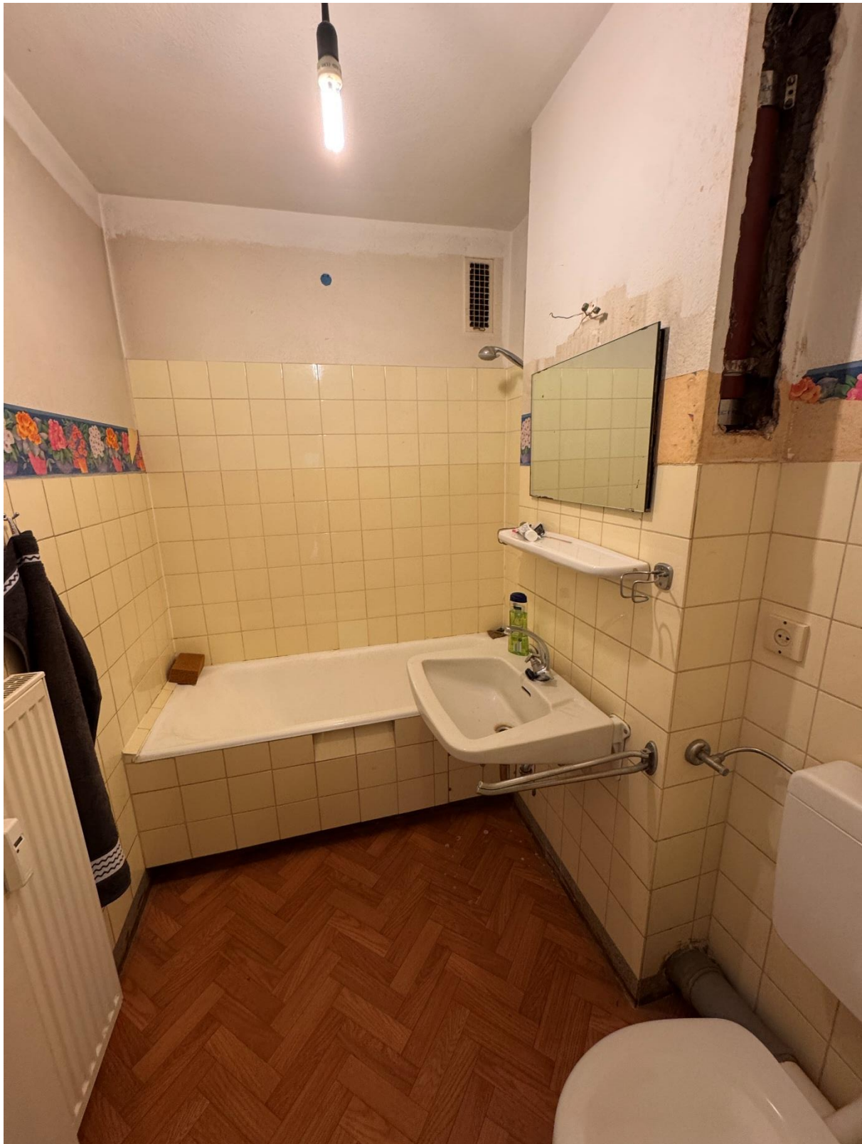
Öffnung in der Wand, wird auf Kosten der Wohnungseigentümergeinschaft wieder fachmännisch verschlossen
